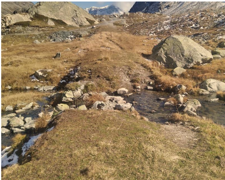
Abbildung 10: Beschädigte Stelle des Dammes welche mit einer Brücke überbaut, wird
